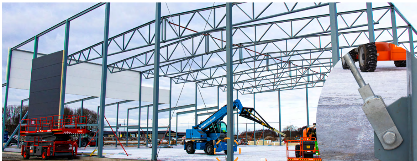
PDS-dragstag stagar upp konstruktionen i Padelhallen "Padelzone" i Varberg.
